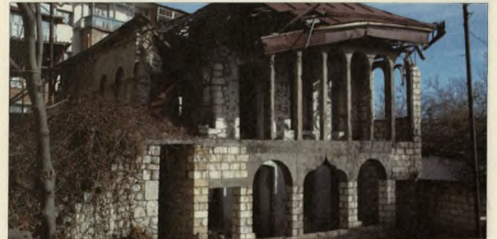
Dağıdılmış yaşayış binası
