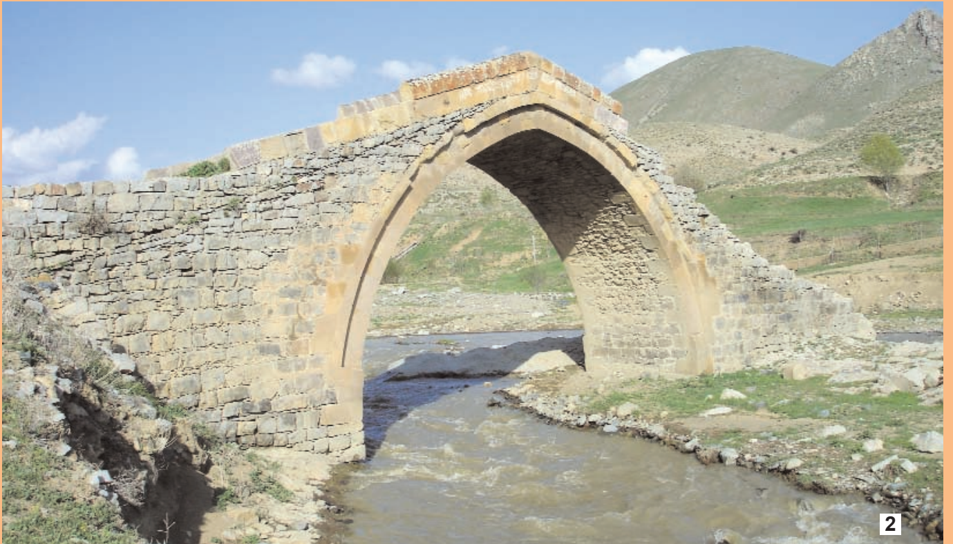
Qazançı körpüsünün: 1. Şimal görünüşü. 2. Cənub görünüşü. A view of Gazanchi bridge 1. North view. 2. South view.
